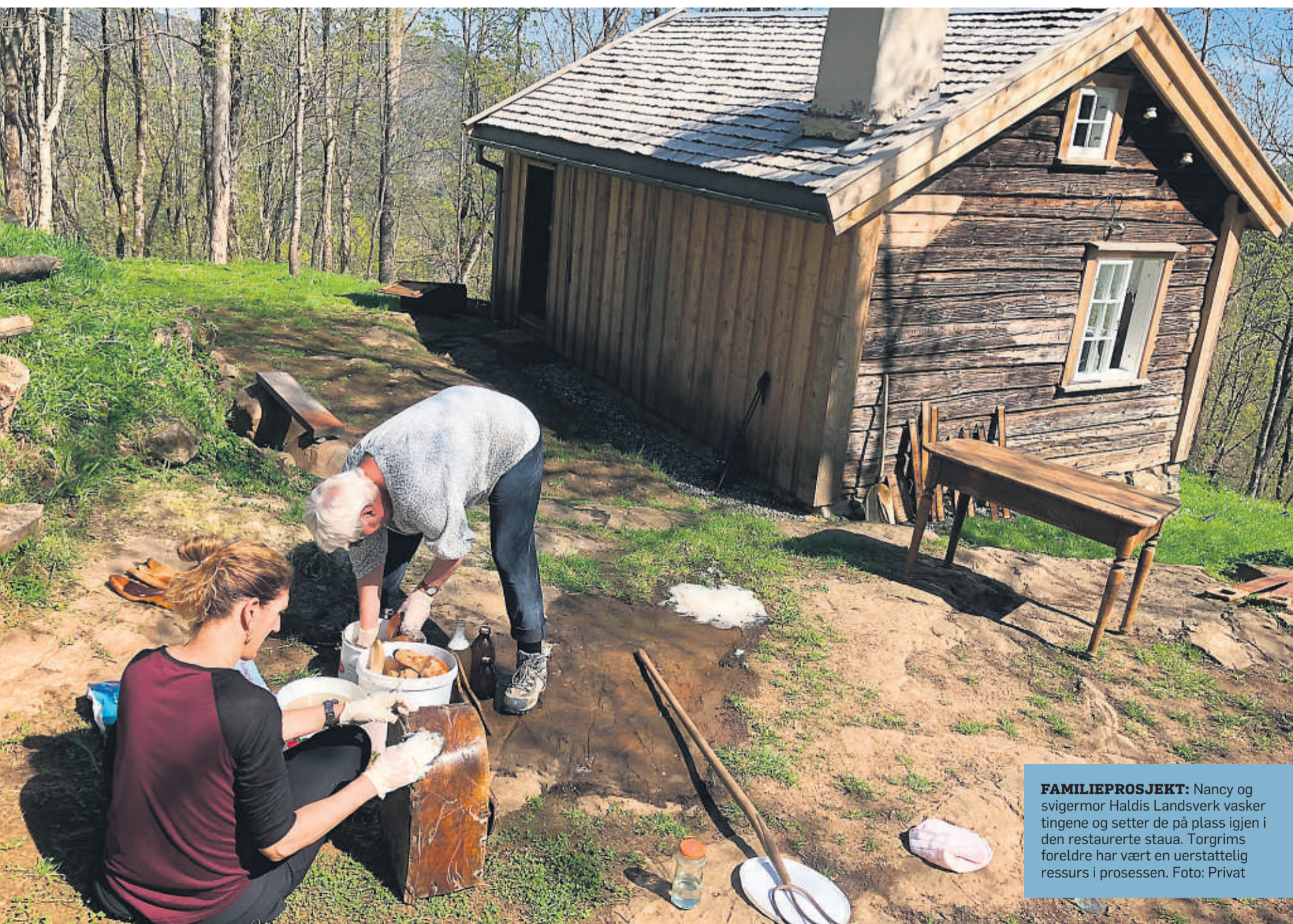
JUNI 2016: Mye av nordvestsiden av tømra på «staua» måtte skiftes ut på grunn av fukt- og maurskader. Foto: Privat
