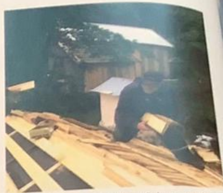
Torbjørn fra Gryting Trelast AS, leverte stikkene av gran og andre materialer til istandsettingen.
